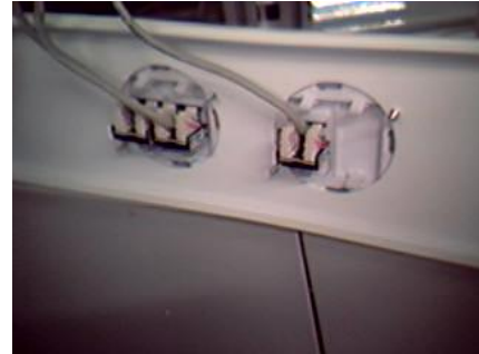
Conexiones de las tomas de la red interna.
